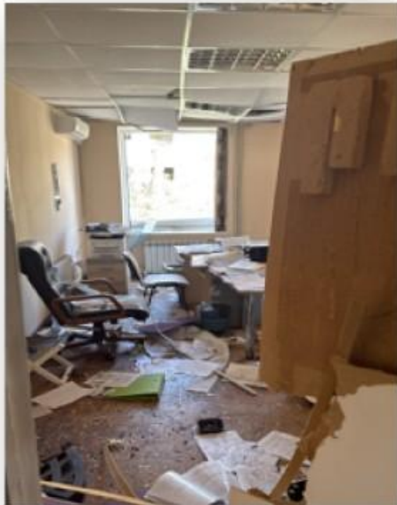
Пошкодження Університетської лікарні 1 липня 2026 року (сума для відновлення – 18 207 413 млн. грн.)
